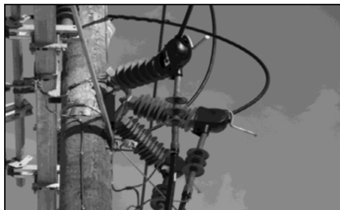
Joonis 174. Mastile paigaldatud 20 kV kaabli otsamuhv.
