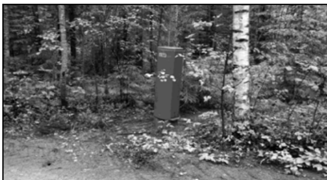
Joonis 116. Plastist valmistatud jaotuskapp (Suur-Savon Sähkötyö).
