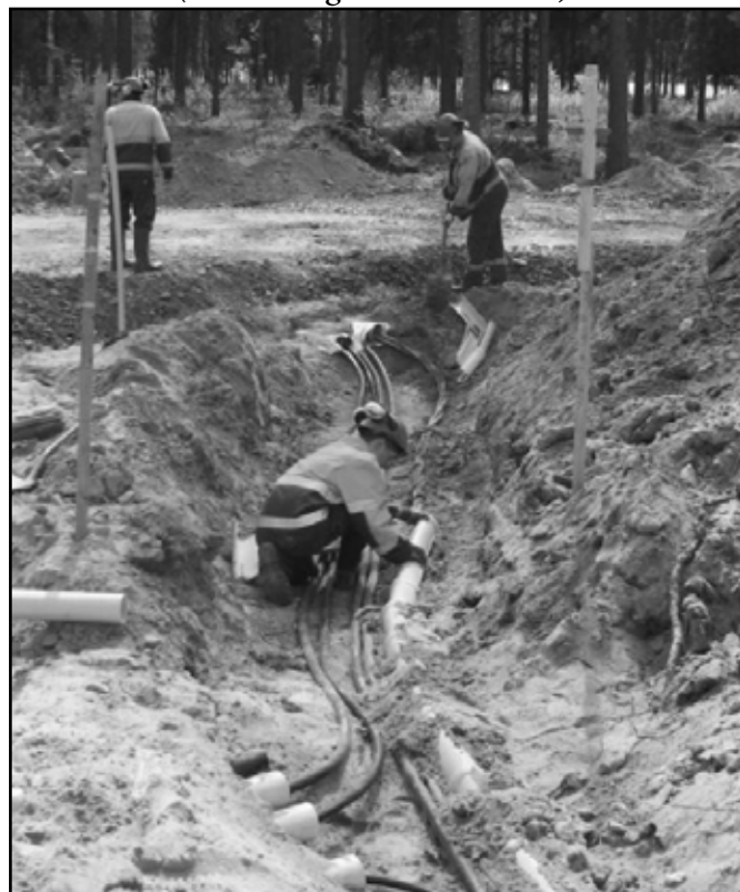
Joonis 159. Kaablirennid kaablikraavis (Suur-Savon Sähkötyö).
