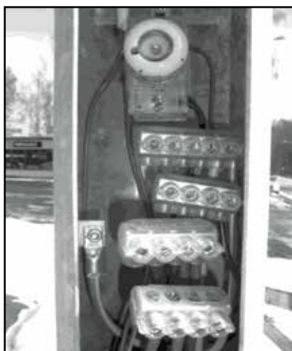
Joonis 76. Valgustimasti ühendustarvikud paigaldatuna masti ühenduskambrisse.
