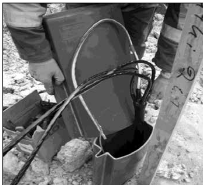
Joonis 115. Kaablid on tõmmatud plastist valmistatud jaotuskappi (Suur-Savon Sähkötyö).
