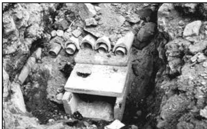
Joonis 162. Tânava allmaaviiguks paigaldatud betoonist kaablikanalali element.
